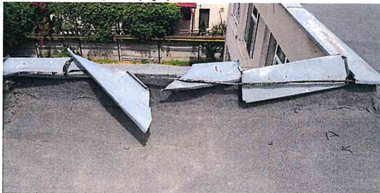
Fig. 5-Sorțuri de tablă degradate/desprinse
