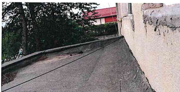
Fig. 1-Degradări structurale: tasare stâlp și deplasare pe verticală terasa intrare
