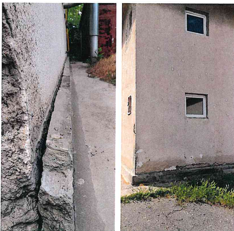
Fig. 2-Degradări la nivelul soclului și al trotuarului
